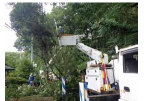
02 倒木により電柱が傾く
